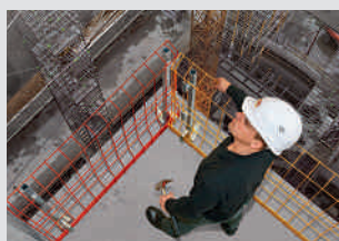
Sistemas de Seguridad
